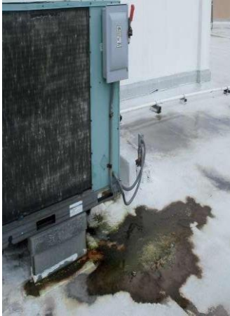
Líneas de drenaje de condensado desconectadas como
