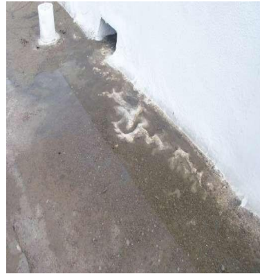
Deslaminación por sumidero ocluido y estancamiento de agua
