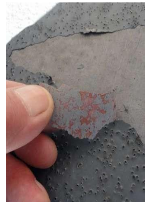
Deslaminación por mala preparación del soporte
