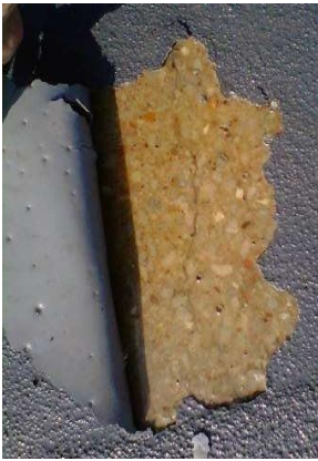
Deslaminación debido a la humedad
