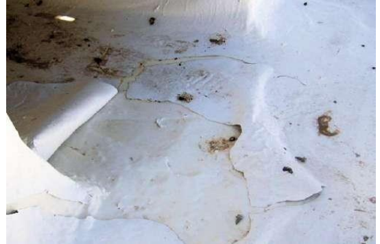
Desaminación debido a una limpieza inadecuada
