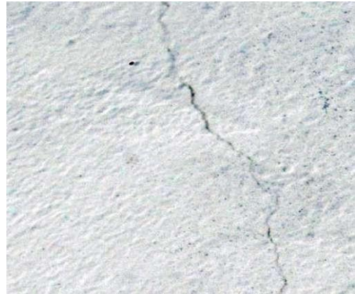
Grieta en revestimiento telegrafada
