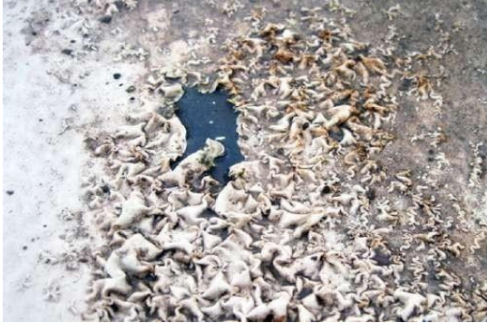
Deslaminación debido a la fina capa superior y al encharcamiento
