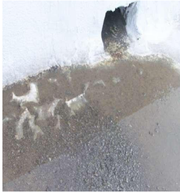
Sumidero instalado demasiado alto.
