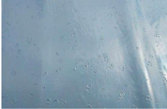
Lluvia sobre revestimiento no curado.
