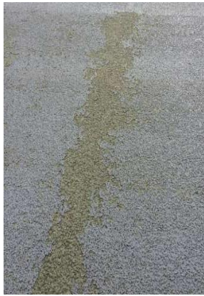
Deslaminación debido a materiales incompatibles
