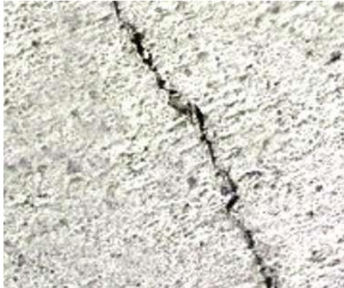
Grieta antes del recubrimiento
